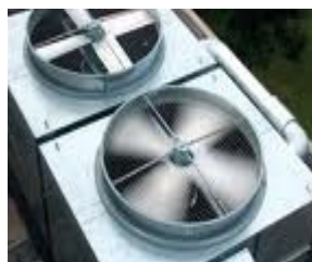
HVAC PHE, EHE, SHELL
